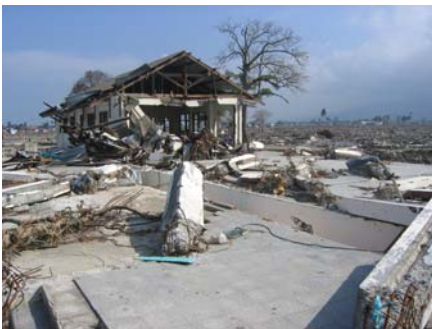
津波によるすさまじい力で、鉄筋柱が倒れている様子。
