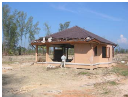
Ban Nok Naでの津波被害状況
