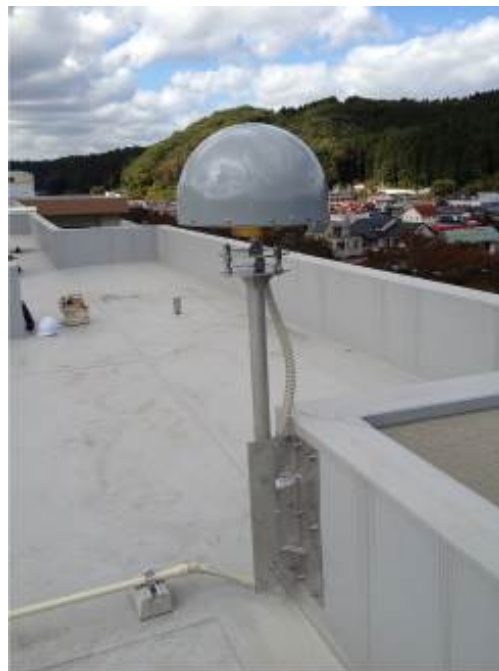
図2 福島県石川町立石川中学校観測点におけるアンテナ取付状況
