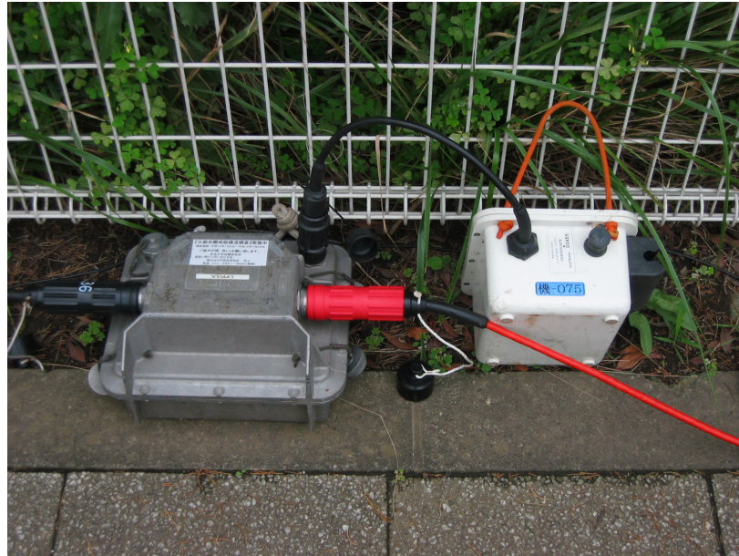
写真4 RSU (GDAPS-4A System) 観測データのA/D変換、データ収録部への伝送を行う。右側は、バッテリーユニット。
