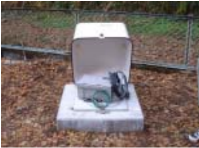
地震計台に検出器設置状況
