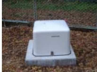
地震計台 FRP 製の保護カバー
