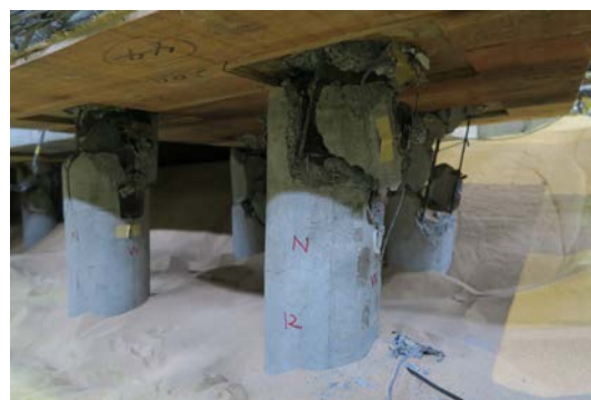
写真 3 内山波 300%終了後の杭の損傷状況
