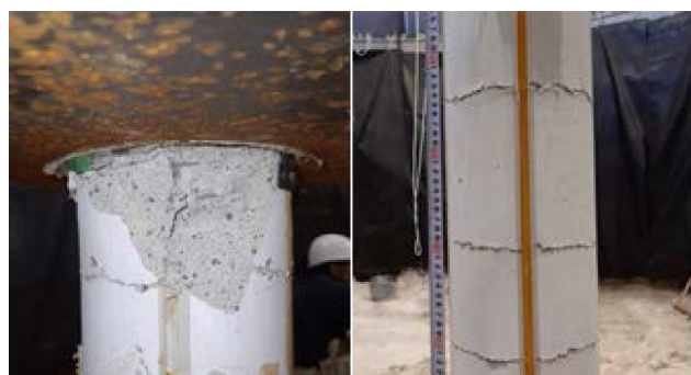
(a) 杭頭損傷状況 (杭 5 東側)
