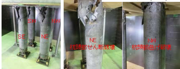
写真2 加力終了後の杭の破壊状況(杭頭部)
