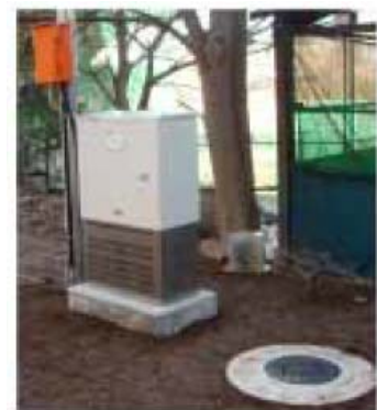
図 20. テレメータ装置 外観
