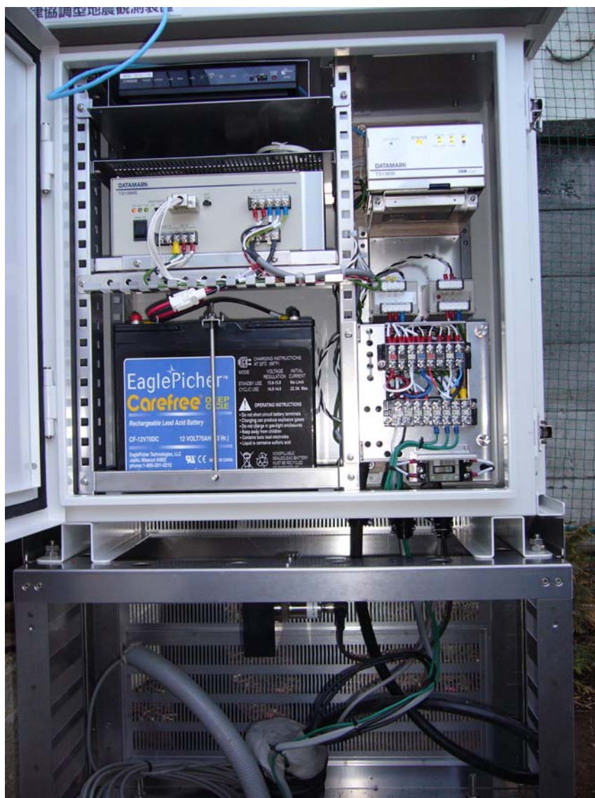
図 2. 地上部装置外観図。左上から、ISDN ルータ、電源制御装置、蓄電池。 右上から観測制御装置、アレスタ・端子台。
