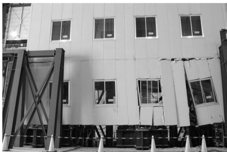
B構面外壁損傷
