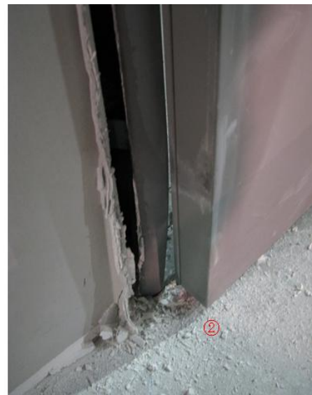
①仕上げボードの脱落 ②ドアフレームの変形
