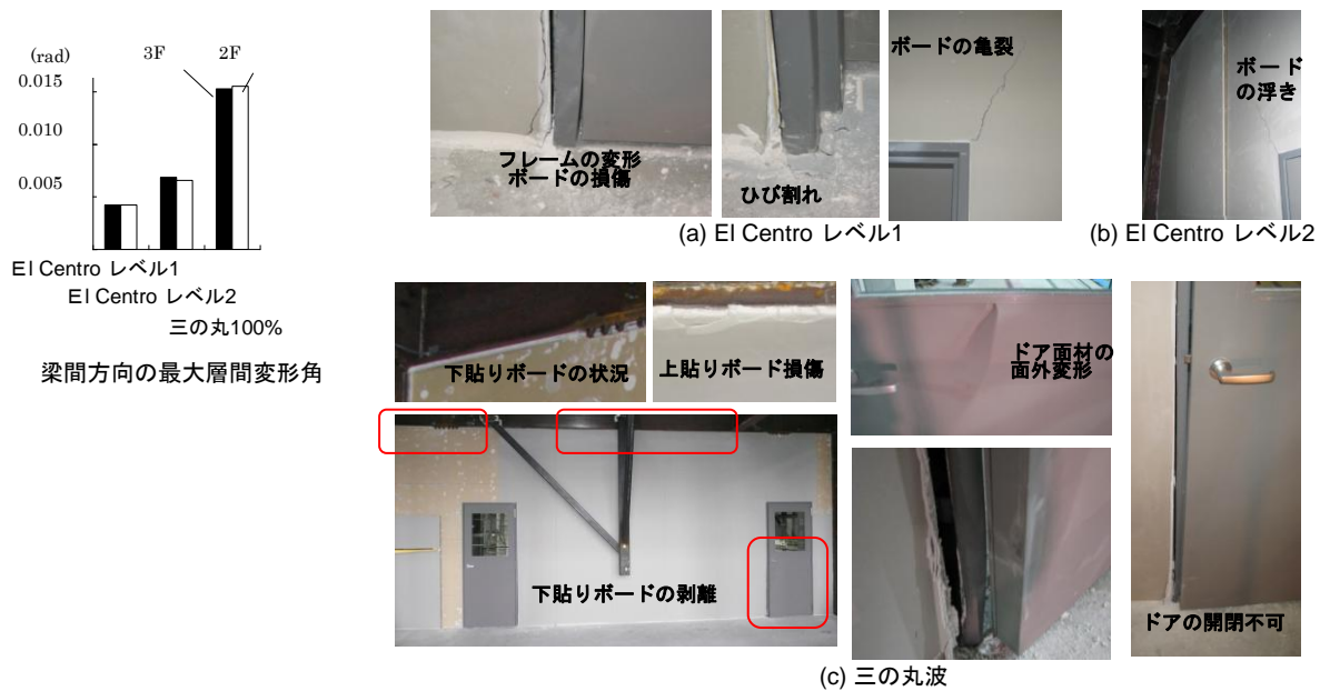
図 4.1- 50 軽量下地間仕切りの損傷状況 (試験体 2 階)
