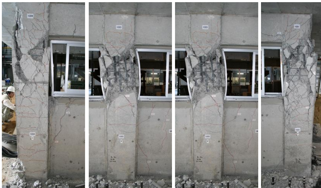
図 4.1-13 JMA 神戸 100%・基礎固定 (Run6) 入力後の旧基準試験体の X1 構面の状況
