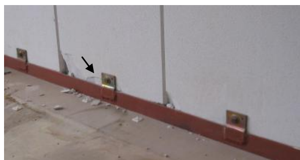
図 4.1- 48 ALC 版外壁の想定応答変形実験後の損傷状況
