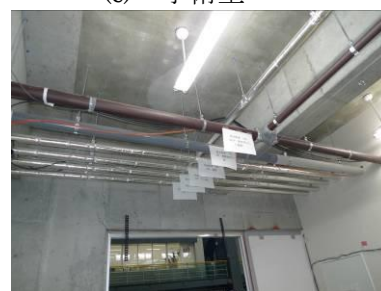
(f) 給排水配管
