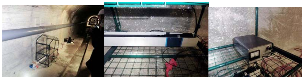
図1 シンチレーションカウンター、電源BOX設置状況
