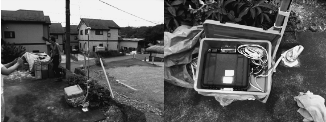
図 1. 平成 25 年 7 月 1 日に実施した TC30 の点検および保守 外装や DAT5A に異常は見られなかった。
