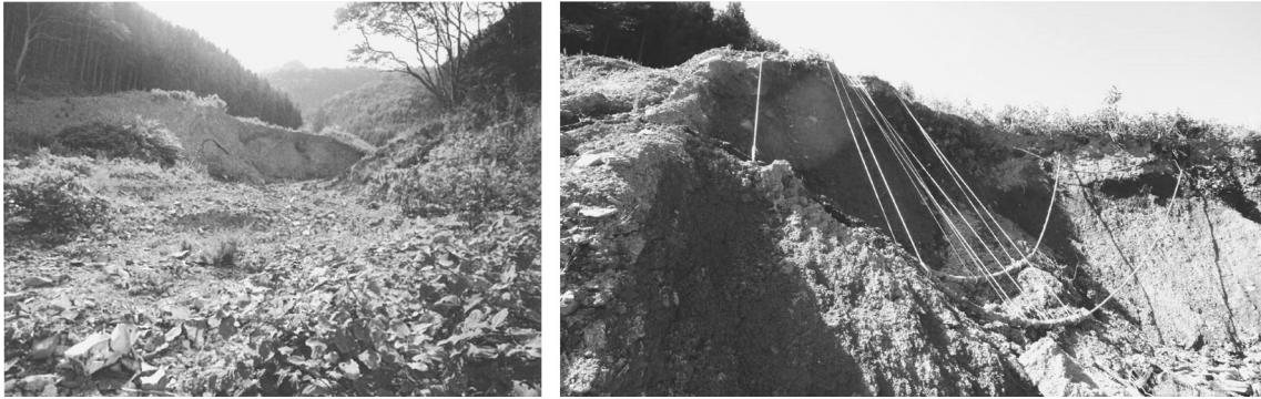
図 3. 平成 23 年の台風 15 号の影響で八木浜は土砂崩れを起こし、埋設した光ケーブル/ビーチアースケーブルが露出した（左）ため、応急処置としてロープでたるみを支えた。
