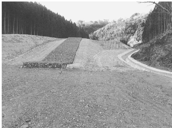
図 4. 土砂崩れを起こした部分を大幅に造成した。石を入れた布団かごの下には光ケーブルが埋設されている。
