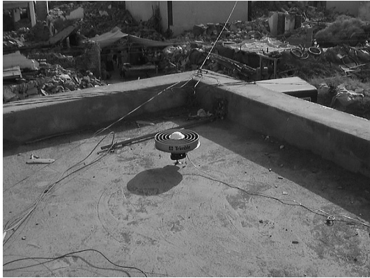
図2 設置されたGPS アンテナ。
