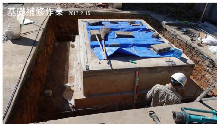
図1 震源装置の基礎の補修工事。 周辺地盤を掘削して拡張をしている
