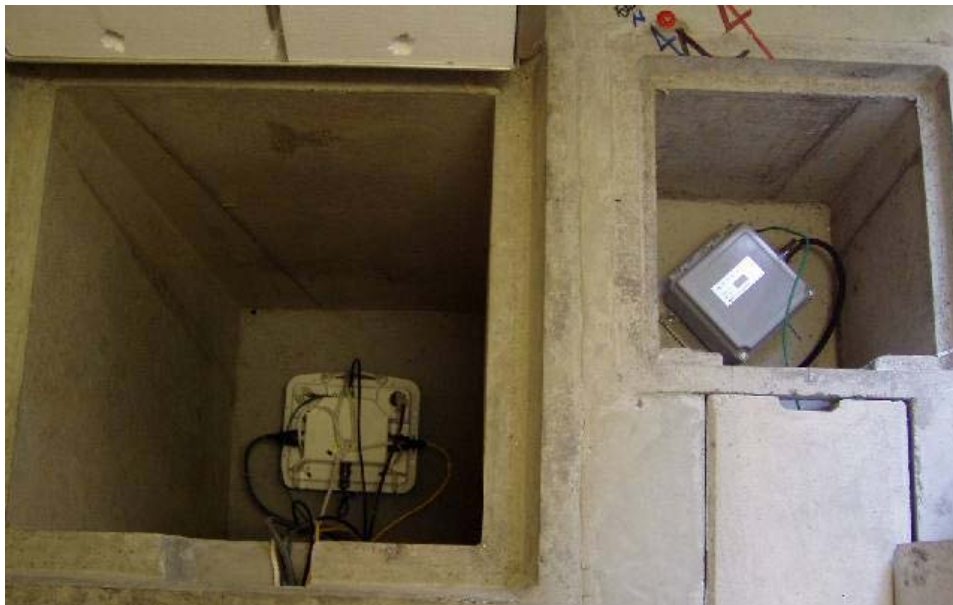
図 32 観測施設内地下ピット
