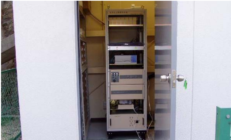
図 33 地上装置機器収納ラック
