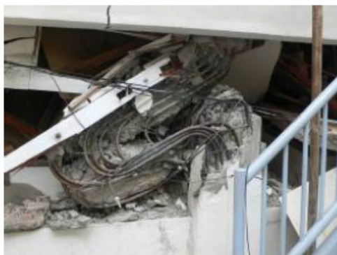
図-2.3 柱断面縮小と自重による主鉄筋の座屈
