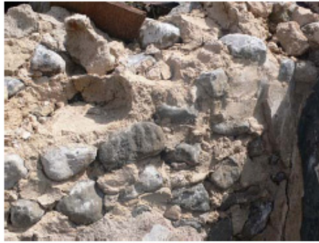
Kudu 村の民家の壁、手で崩せる
