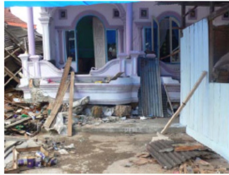
Alai 村の住宅、一階の柱が無筋のレンガ造
