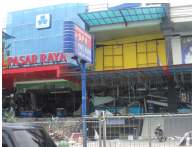
津波避難ビル候補の1つ（1階のフローアは完全に押しつぶされているが、完全崩壊でなく、人が歩ける程度の空間はあった）
