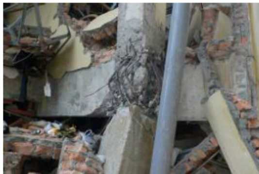
図-2.4 接合部コンクリートの圧壊と脱落
