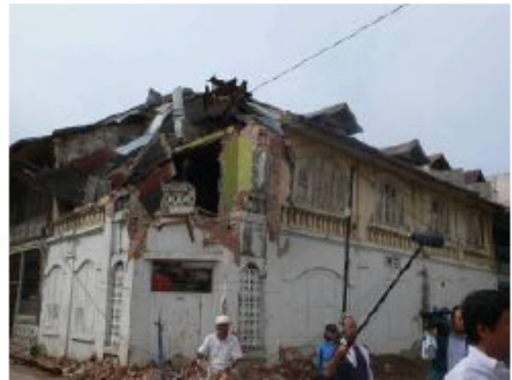
図-2.7 歴史的レンガ造建物の被害
