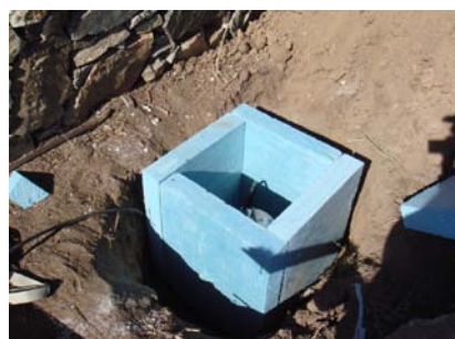
写真 1 地震計穴 (NE66)
