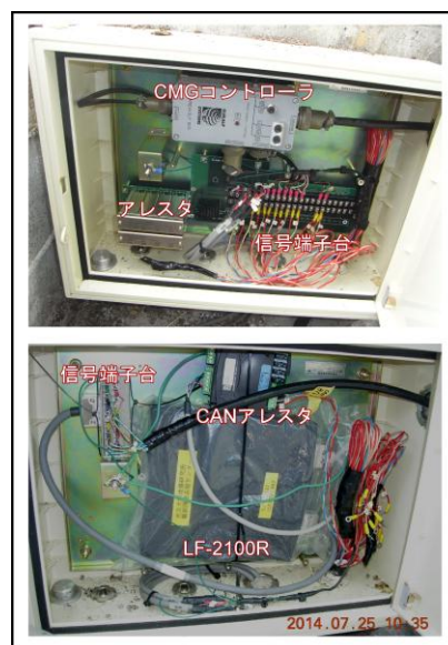
Fig.3 地震計台の収納ボックス内部 (上：CAN 通信化前，下：通信化後)
