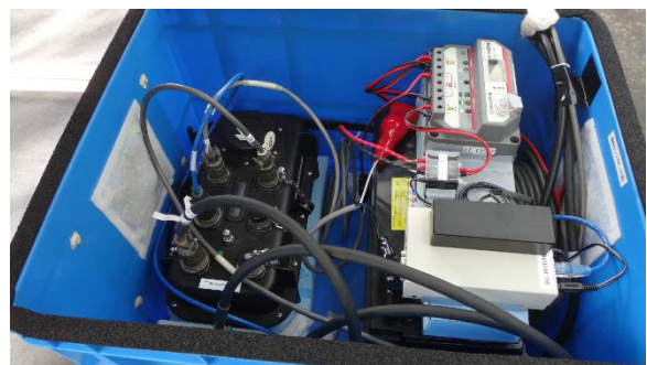
図 7. 機器収納 BOX の内部
