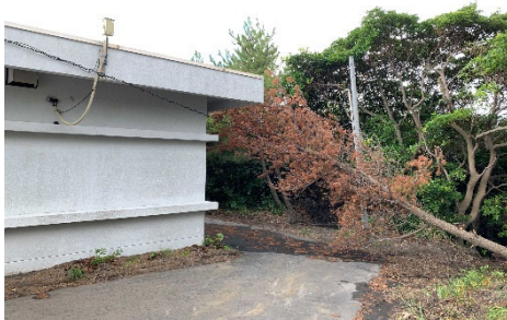
図 2. 光通信ケーブルへの倒木状況
