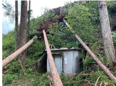
図 3. 加治木観測室の被災状況
