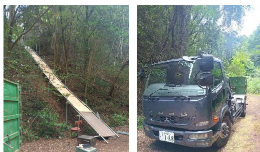
図 3 a)設置した荷物用スライダー
