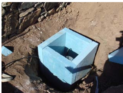
写真1 地震計穴 (NE66)
