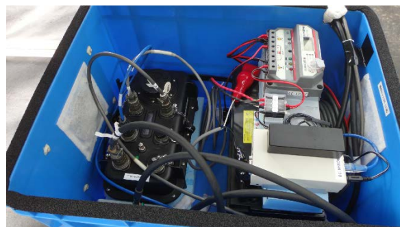
図 7. 機器収納 BOX の内部
