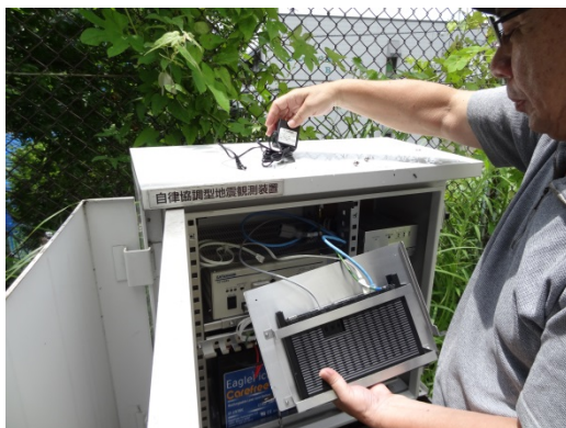
写真 1 ルータの電源コード交換。
