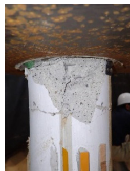
図 12 杭頭部のモルタル圧壊状況
