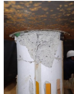
図 12 杭頭部のモルタル圧壊状況
