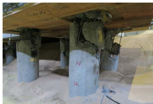
写真 3 内山波 300%終了後の杭の損傷状況
