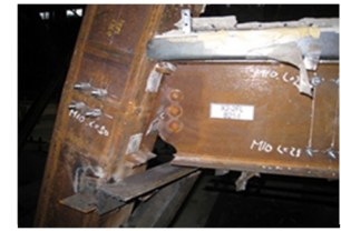
(b) 梁下フランジの破断
