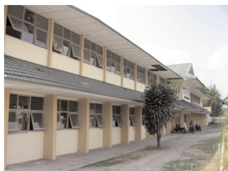
図6 : Wonokromo high school (図2④) 構造形式 : RC Frame + URM 建築年代 : 2003年 被害レベル : 中破
