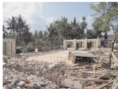
図5 : Pacar elementary school (図2③) 構造形式 : RC Column + URM 建築年代 : 1977年 被害レベル : 倒壊
