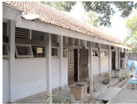
図3 : Bantul II junior high school (図2①) 構造形式 : RC Column + URM 建築年代 : 1980年 被害レベル : 軽破
