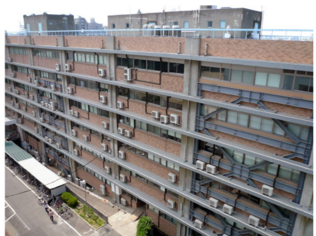
図 3：耐震工事によって取り付けられた地震研 2 号館の鉄骨ブレース
